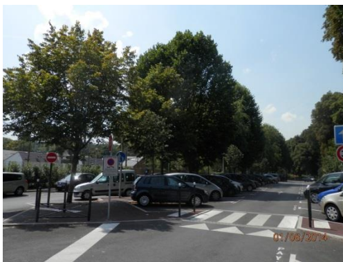
Réaménagement du parking de la gare dans le cadre du SIVU « Garches - Marnes la Coquette » à Marnes la Coquette
