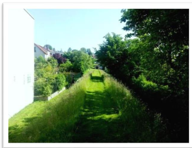
Tronçon de l'aqueduc de l'Avre géré écologiquement, avant la fauche tardive des abords (Source : Eau de Paris, 2013)
